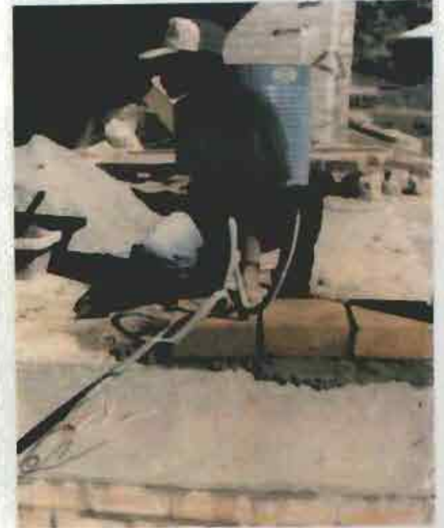
Ci-dessus : Mise en œuvre d'un mur en BTC de 22 x 22 avec passage des gaines électriques. Chaque BTC est taillé en l'absence de blocs avec réservation spécialement conçue pour ce détail.
