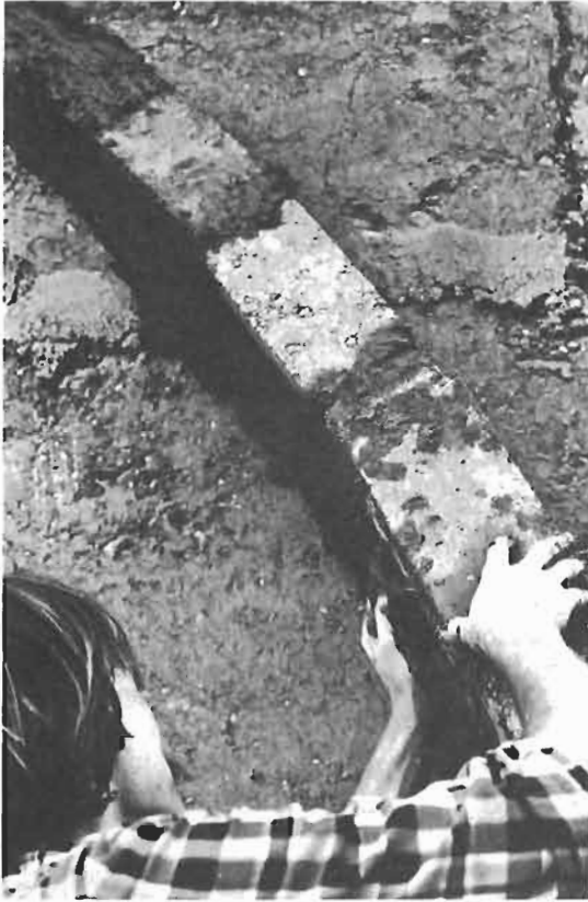
FIGURE 312 : LES BRIQUES SONT POSEES SUR LE BOUT : LA VOUTE A DONC 15 cm D'ÉPAISSEUR
